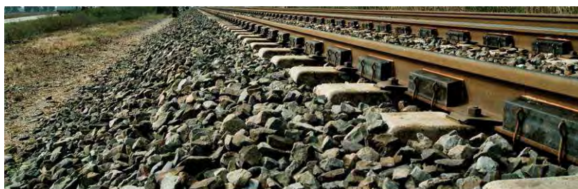
Figuur 2.5: voorbeeld raildempers
